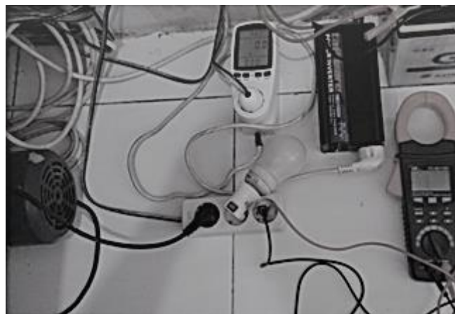
Gambar 8. Pengukuran harmonisa tegangan dengan menggunakan alat ukur
