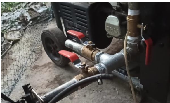
Gambar 20. Pipa Untuk Mengalirkan Syngas
