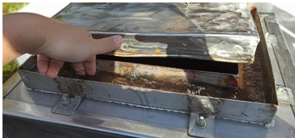
Gambar 15. Air Isolator pada Reactor
