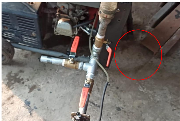
Gambar 17. Valve Pada Sistem Penyaringan
