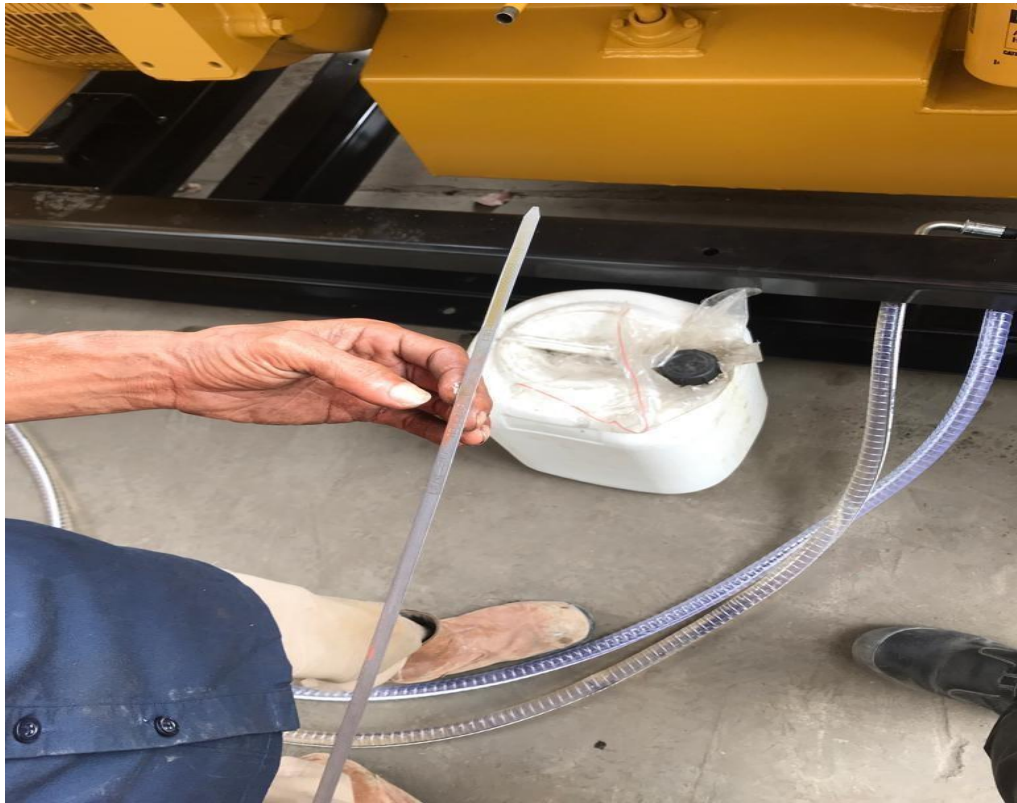
Gambar Pengecekan Oli pada Genset
