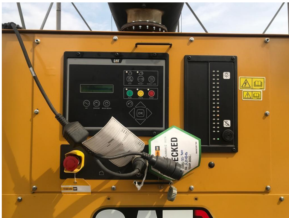
Gambar Tampak Depan Genset yaitu Modul Genset
