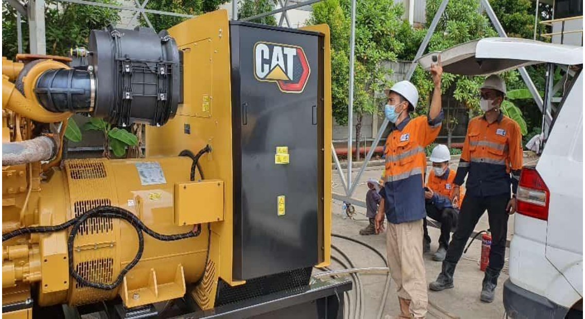
Gambar Genset sudah di lokasi tempat pengujian
