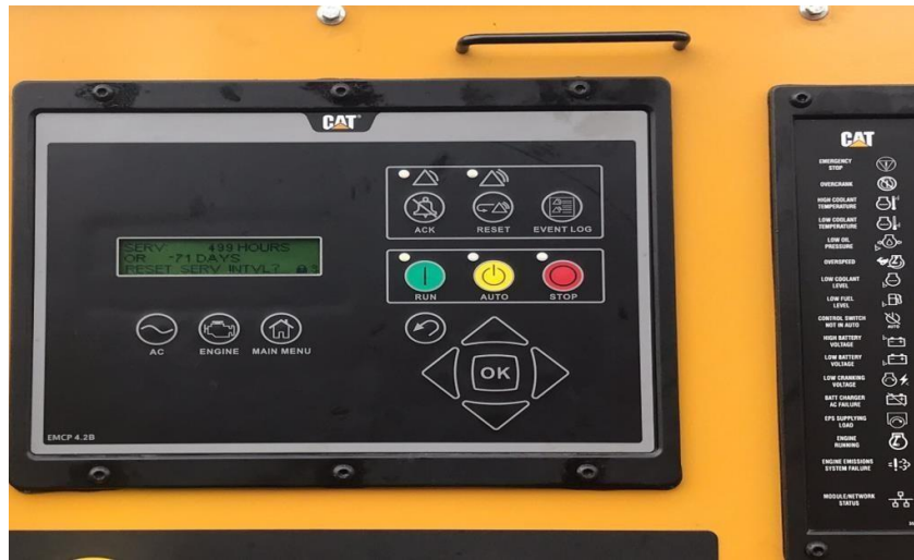
Gambar 2. 6 Modul pada Genset Caterpillar
