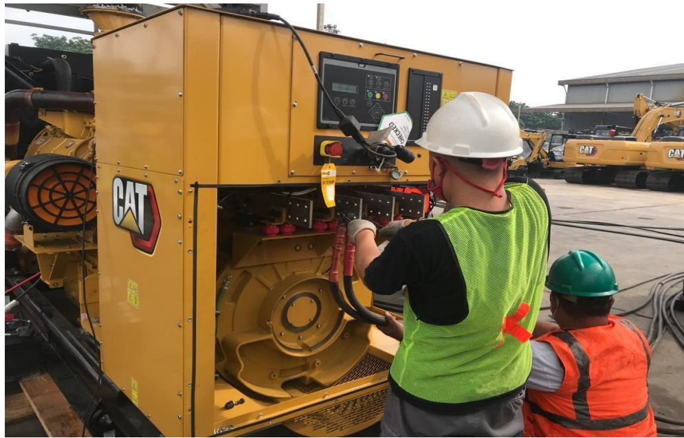
Gambar Mengkonekkan kabel dari Loadbank ke Input dan Output Genset
