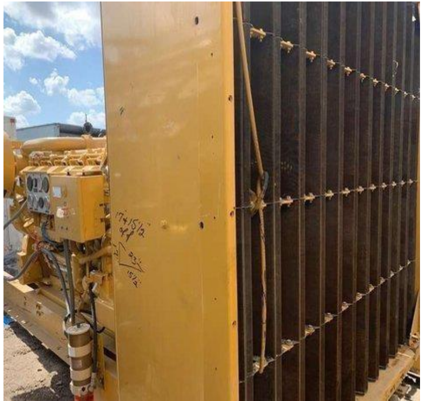
Gambar 2. 3 Radiator sebagai pendingin genset
