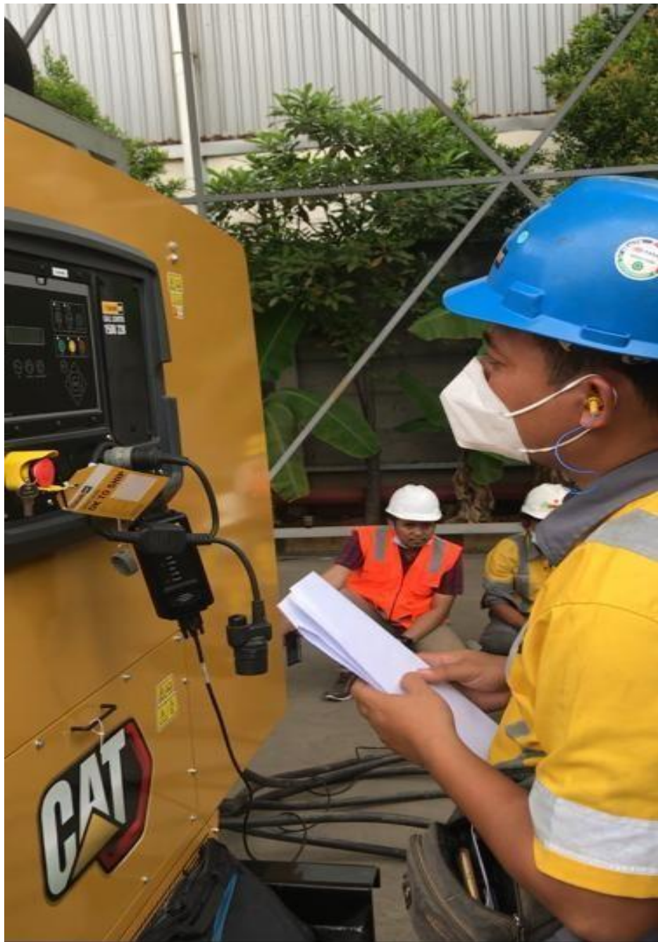
Gambar Pengambilan Data Hasil Pengujian di Modul Genset
